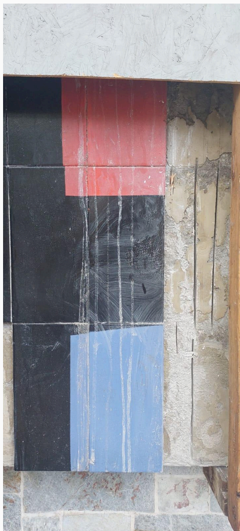
Detalhe de peças – estado de conservação precário Autoria: Maria Letícia Ticle Data: 12/03/2024
