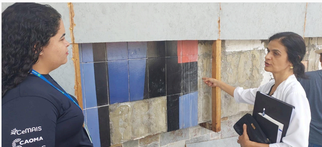
Uma das peças de tapume removida e apresentação do painel e suas patologias
